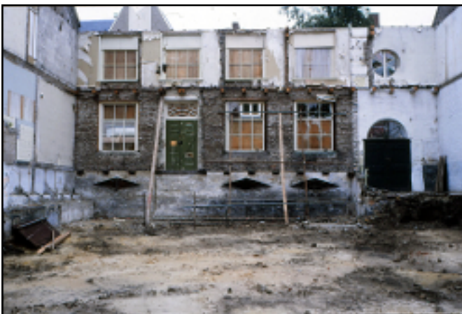
Alleen de gevel staat nog overeind. Het interieur van het huis is compleet verdwenen.
